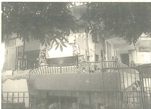
921 震後一樓側面
