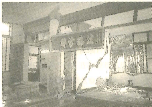
921 震後一樓內部
