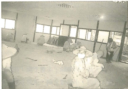
整理臨時圖書館之地板（因地板出水）
