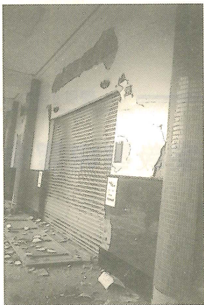
震後大殿一樓評為危樓
